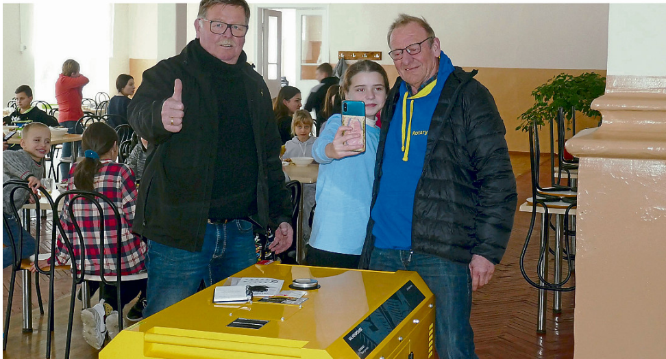
Die aus dem Münsterland gelieferten Notstromaggregate laufen in vielen zivilen Einrichtungen, wie hier in einem Landschulheim, in dem Flüchtlingskinder ohne Erwachsenenbegleitung untergebracht sind. Claus Muchow und Hermann Köning wurden von den Kindern herzlich begrüßt.
